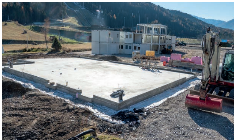
Am Seefelder Tennisplatz entstehen derzeit das „Stora Enso“-Ausstellungsgebäude und ein VIP-Bereich, im Hintergrund die WM-Tribünen. Foto: Rangger
